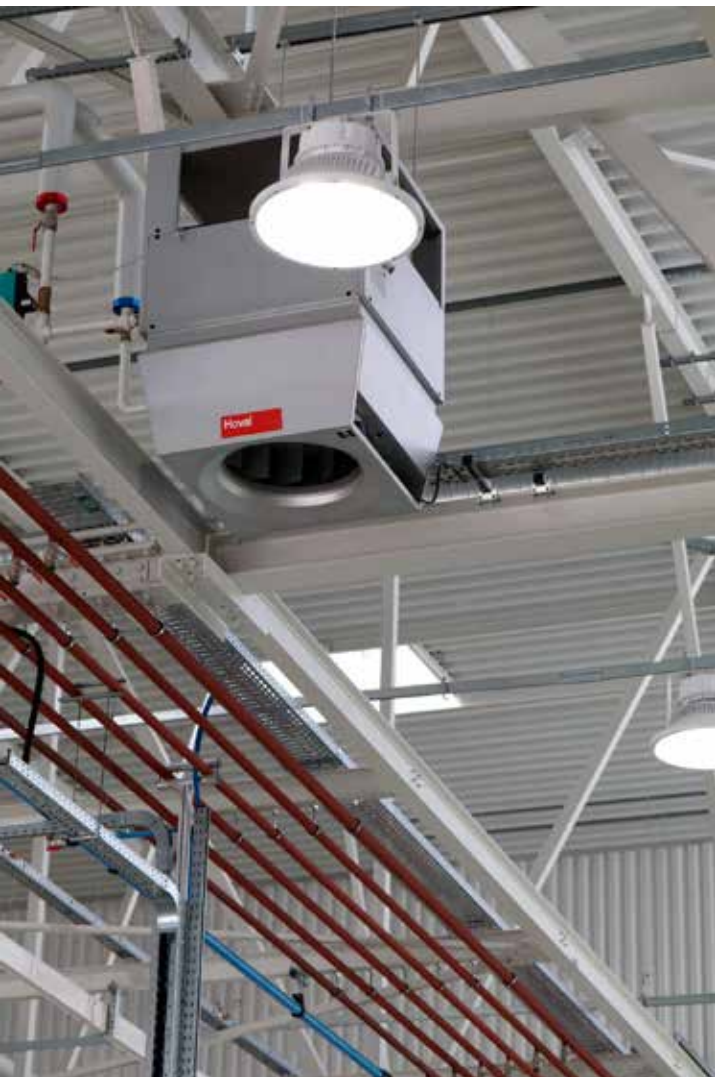
Les unités décentralisées (sans gaine) de recyclage de l'air peuvent être intégrées dans l'infrastructure du hall, sans devenir un obstacle pour les équipements (racks, ponts roulants, éclairage etc.).
