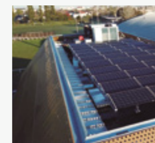
Amandiers (complexe sportif) Carrières-sur-Seine, France ECOi-W
