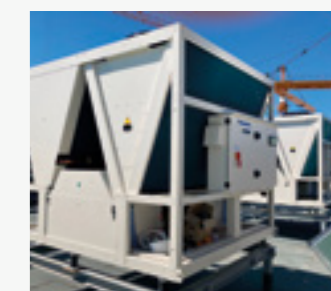
Cédus Liget (installation complexe comprenant des appartements, des bureaux et des unités tertiaires) Szeged, Hongrie ECOi-W, ECOi et VRE
