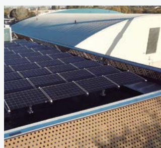
Amandiers (complexe sportif) Carrières-sur-Seine, France ECOi-W
