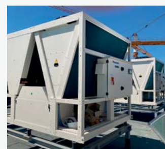
Cédrus Liget (installation complexe comprenant des appartements, des bureaux et des unités tertiaires) Szeged, Hongrie ECOi-W, ECOi et VRE
